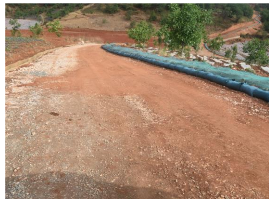
道路水土保持措施
